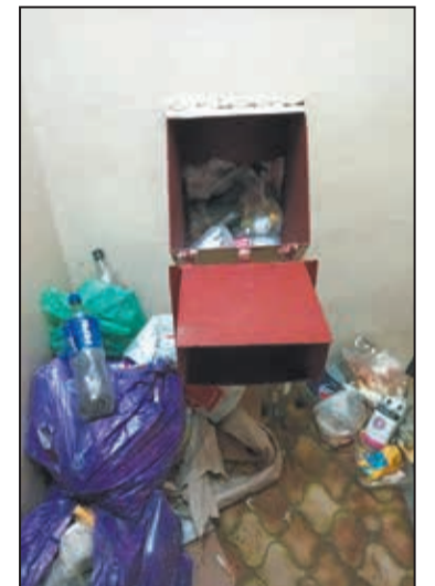
Zapchany zsymp przy ul. Hubala 18c
