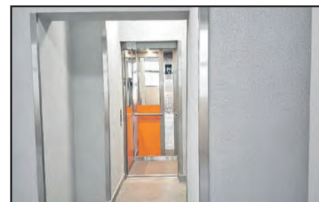
Wymiana dźwigu osobowego Skautów Opolskich 7 wraz ze strefą wejścia z poziomu „O”
